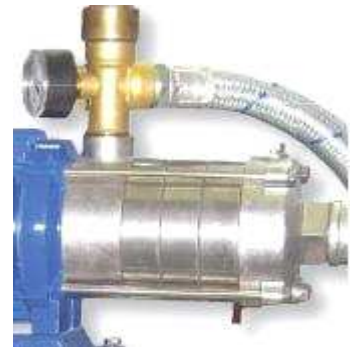
Abbildung 4: Druckleitung der Mehrstufenpumpe mit Druckmesser, die durch Druckwandler ausgetauscht werden kann
