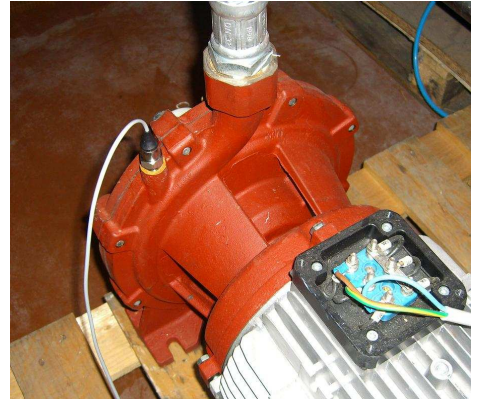
Abb. 3: Montage des Druckwandlers an der Einfüllöffnung der Zulaufseite
